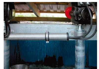
Das Schwallbecken: Hier sammelt sich das Wasser nach der Aufbereitung und wird schubweise in den Teich geleitet.
